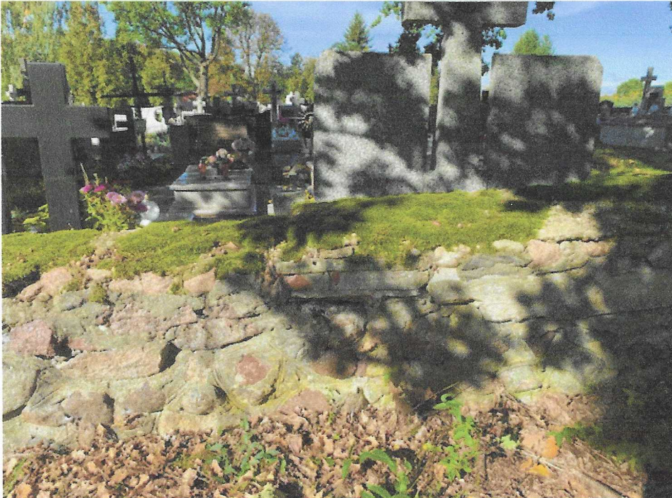
Ubytki kamienia w ogrodzeniu. Widok od strony wschodniej
