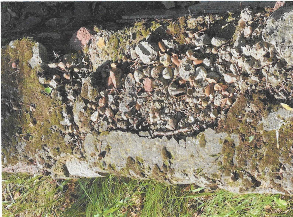
Ubytki w betonowej czapie scalającej ogrodzenie
