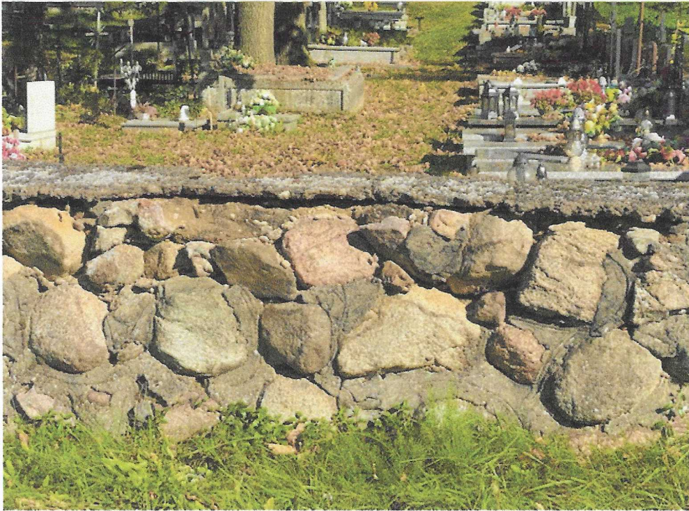
Ubytki w zaprawie betonowej od strony południowej
