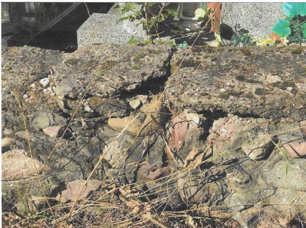
Pęknięcia betonowej czapy i ubytki w ogrodzeniu. Widok od strony wschodniej.
