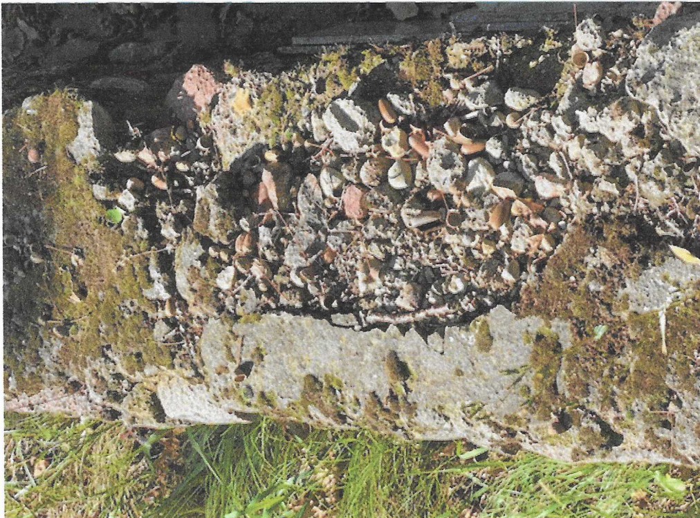
Ubytki w betonowej czapie scalającej ogrodzenie
